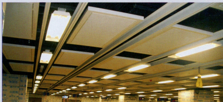
地鐵安裝之燈盤
